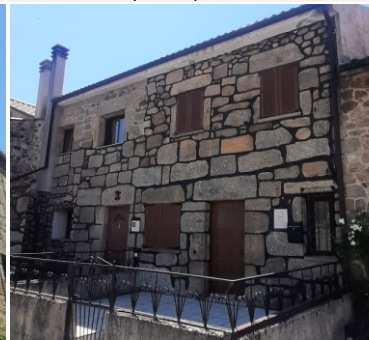
Caixas de contadores, juntas avivadas, algerozes e caleiras com cores divergentes às caixilharias
