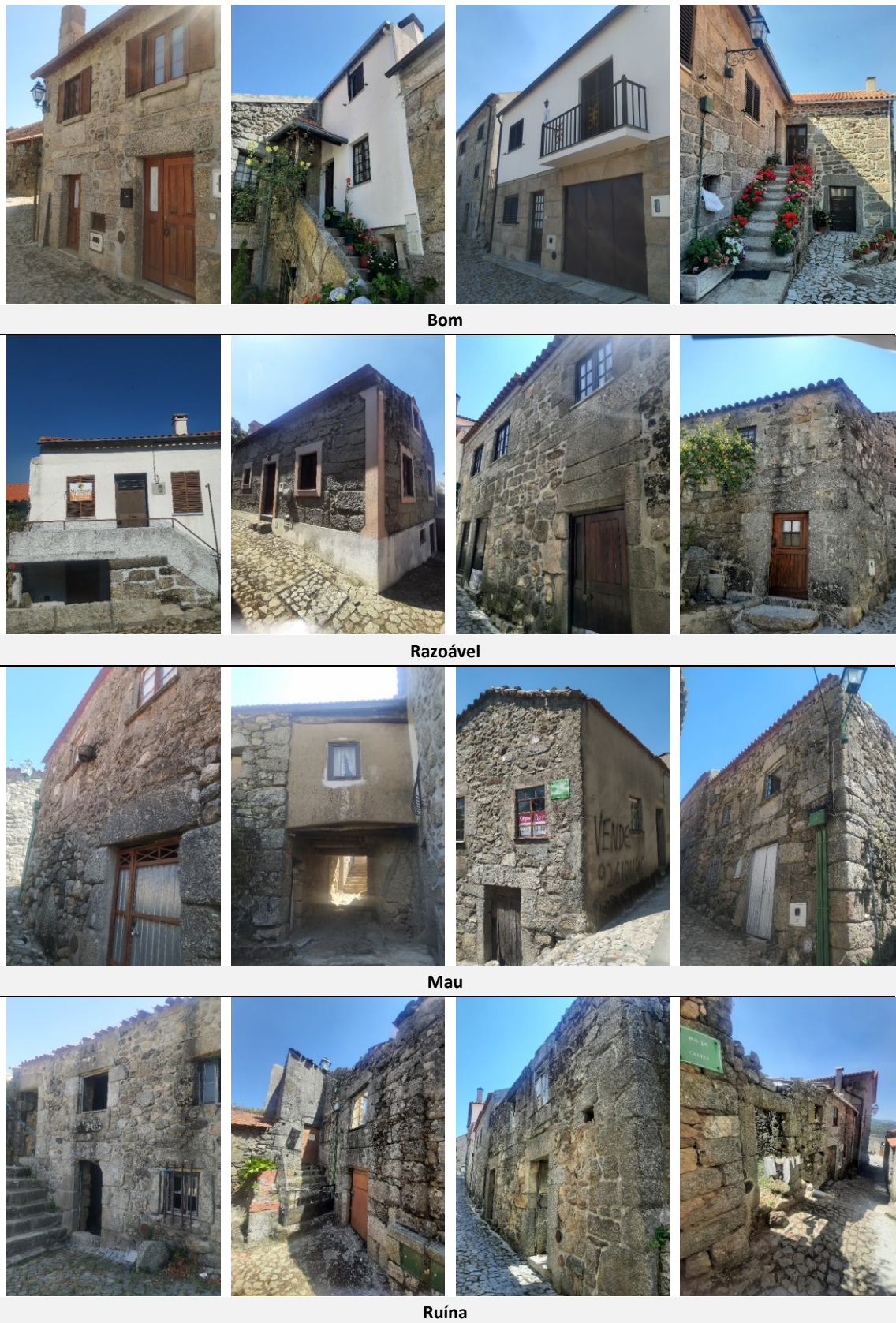
Figura 16. Exemplos do estado de conservação do edificado da ARU
